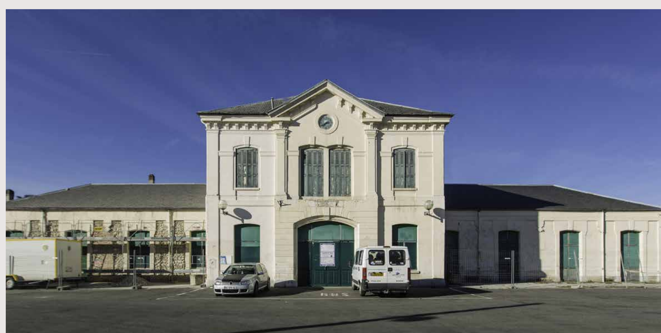
Les façades extérieures gravement appauvries par la SNCF dans les années soixante.
