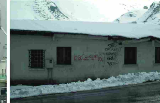
FAÇADE ARRIÈRE DÉLAISSÉE
